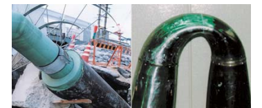
災害に強い中圧ガス
