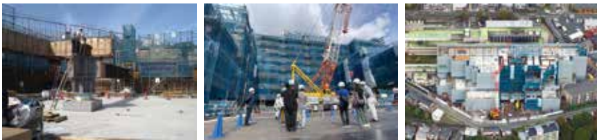
(免震装置設置状況 令和4年3月) (市民向け工事現場見学会 令和4年9月) (本館建設工事状況 令和4年10月)
