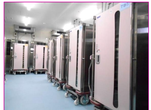
* 再加熱カート・ステーション *
